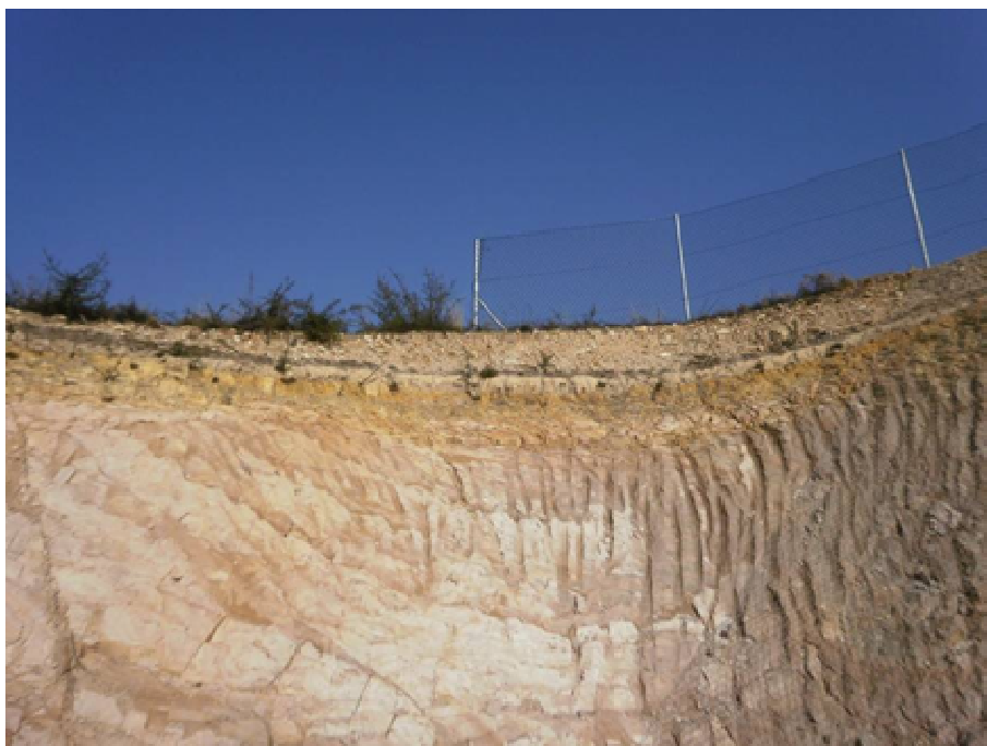
Figura 28 – Depósitos recentes, na parte superior do talude, com uma espessura de aproximadamente 1 m, a Este da área afecta ao estudo, recobrindo a formação metamórfica.
